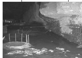
万达地下墙渗漏
