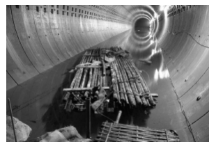
董家渡浦东隧道渗水
