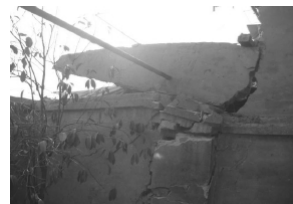
9号线七宝路站房屋沉降
